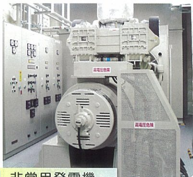
非常用発電機
