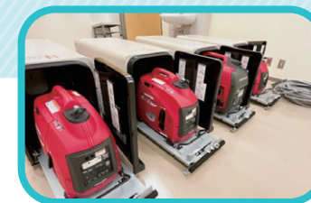
ポータブル発電機(予備)
